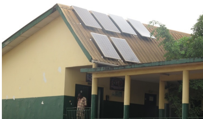
Les panneaux solaires récemment installés au Centre médical communal Les Flamboyants assurent une source stable d'électricité pour l'établissement. Les panneaux solaires fournissent également de l'électricité pour la lampe à fente du service d'ophtalmologie, également fournie par le Projet. Photo : Kate Litvin, APC
